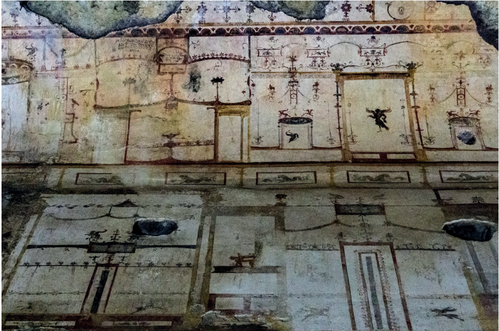
Figura 1. Domus Aurea , siglo I d. C., Roma. Los murales romanos se encuentran muy deteriorados, entre otras causas, se aprecian infiltraciones de humedad. A pesar de ello, podemos distinguir roleos vegetales, elementos arquitectónicos como columnas y arquivoltas, así como personajes compuestos por elementos animales, humanos y posiblemente vegetales (foto: José Luis Pérez Flores, 10 de mayo de 2015).
